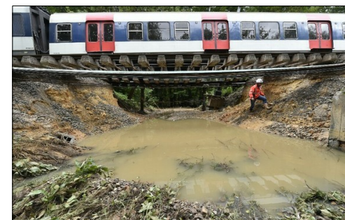
Effondrement talus du RER C
