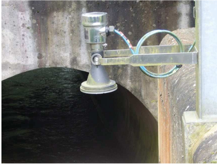
Dispositif de contrôle de niveau des eaux
